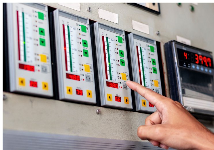
變頻器、感測器、控制器等自動化關鍵零組件，對節能減碳的效用很大，假設一個工廠裡的馬達全面採用變頻器，就能大幅省電30%。（圖為變頻器操作示意圖）
