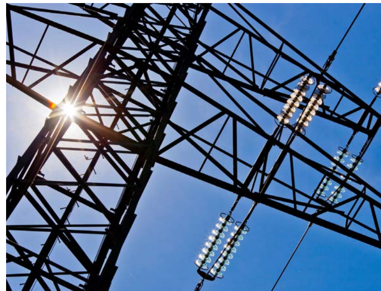
電網韌性攸關供電穩定，工研院長期投入智慧電網、監測和饋線自動化投切技術。
