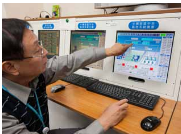
工研院能源管理中控室電力監控系統，可以隨時掌握異常所在，降低漏水率。
