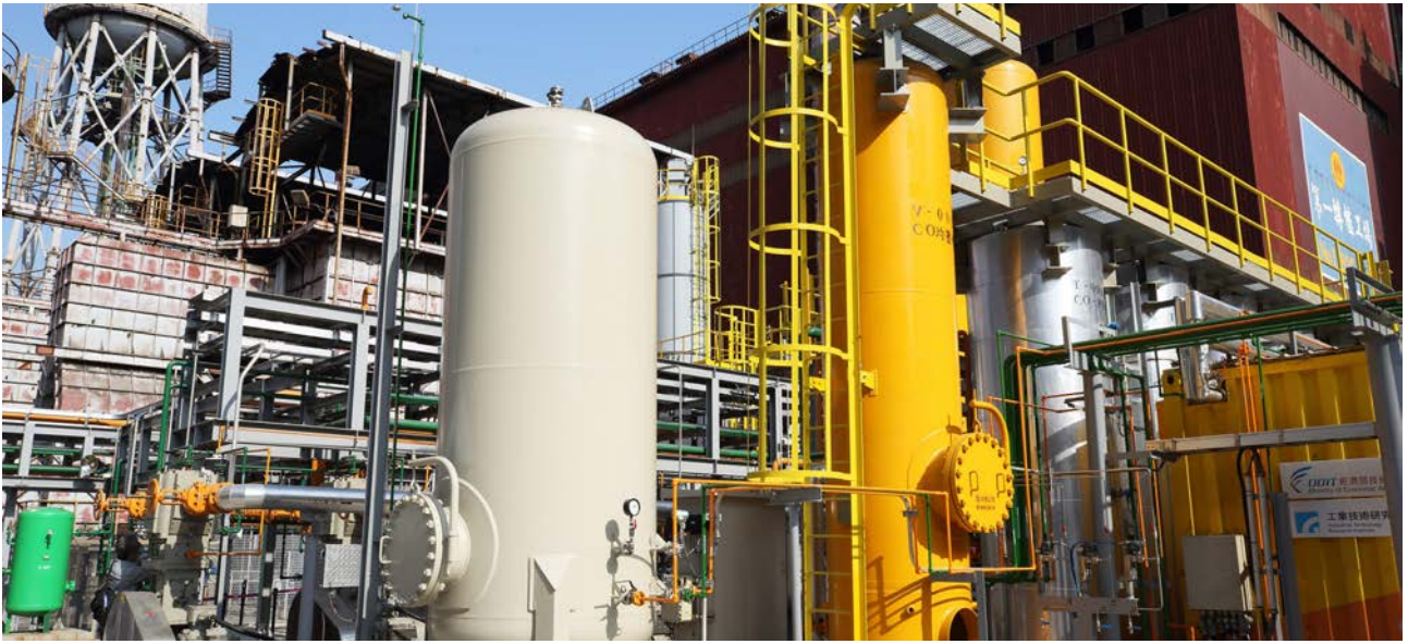
在中鋼廠區內，就近利用管線將高爐及轉爐煉鋼所產生的廢氣導入工場，經過水洗塔降溫及前處理脫硫。
