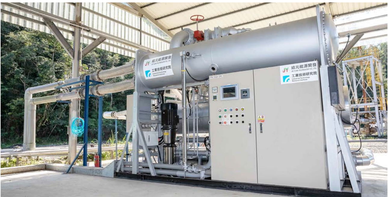
工研院成功打造國內第一座300kW雙循環地熱發電機組，目前在宜蘭清水地熱公園24小時併網運轉中，對帶動國內地熱產業鏈有相當正面的效應。
