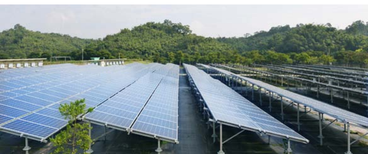
上班日院區用電較多，太陽能輸出能夠減少午間對台電的電力需求。
