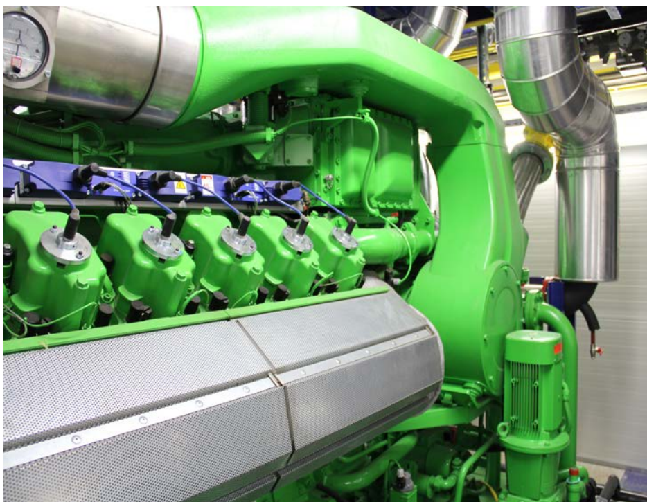
由於汽電共生廠，除發電外，製程用電也頗具規模，若汽電共生廠配合卸除其利潤較低，或較不重要可臨時停電的製程用電，可紓緩台電供電壓力。圖為汽電共生引擎。
